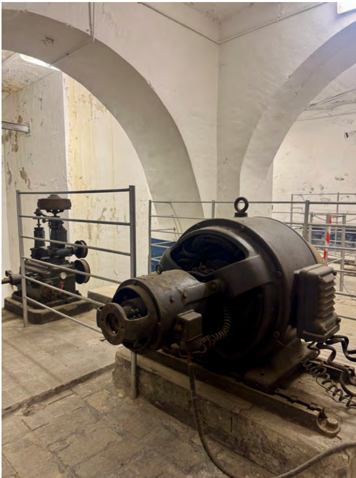
Figura 3. Sala macchine della centrale idroelettrica
