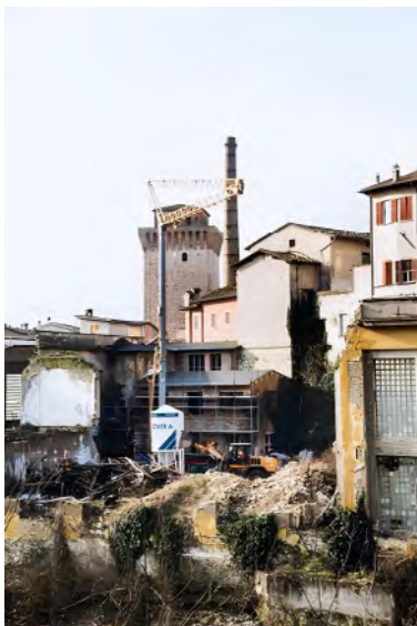
Figura 5. Ex Lanificio Carotti dopo il crollo
