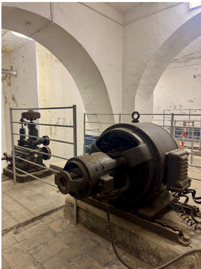
Figura 3. Sala macchine della centrale idroelettrica
