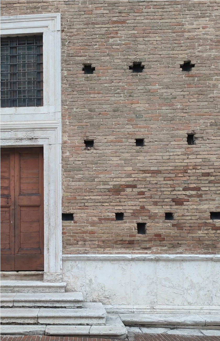
Fig. 13 Urbino, Palazzo Ducale, dettaglio dell'aggancio della panca basamentale ai gradini della porta sul lato orientale della fabbrica (foto dell'autrice)
